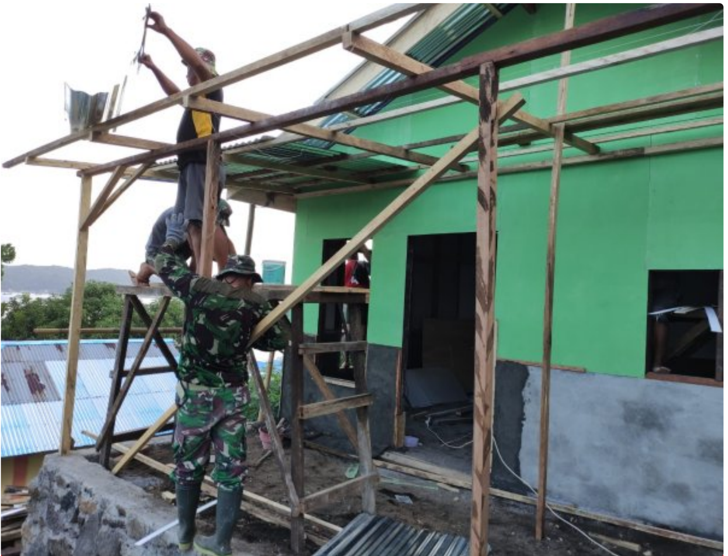
Pekerjaan RTLH Keluarga Galvin Karaki Oleh Satgas TMMMD Ke-116 Kodim 1310 di Kelurahan Tandurusa
